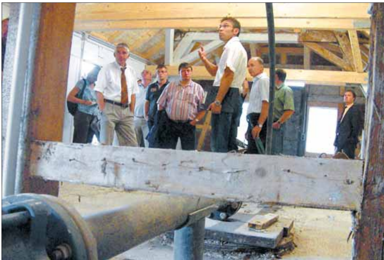
Umfassend in Stand gesetzt wurden zwei der fünf Bohrhäuser am Einsiedelwald. Im Vordergrund entspringt die Leitung dem Solereservoir und versorgt so unter anderem die Kurbetriebe mit in Wasser gelöstem Salz. Foto: Beck
