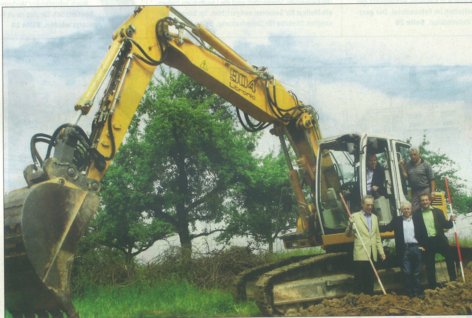
Bürgermeister im Bagger: Dieter Reilinghaus, Schultes Heinz-Peter Hopp, Wilfrid Friedrich von der Baufirma „Dürrwächter und Friedrich“, Baggerführer Harald Vincon und Knittlingens Bauamtsleiter Volker Just (von links) im Baugebiet.
